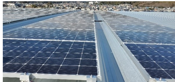
屋上に設置した太陽光パネル
